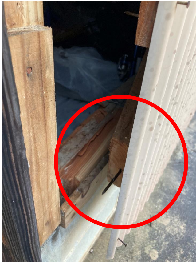
筋交いの引き抜き
